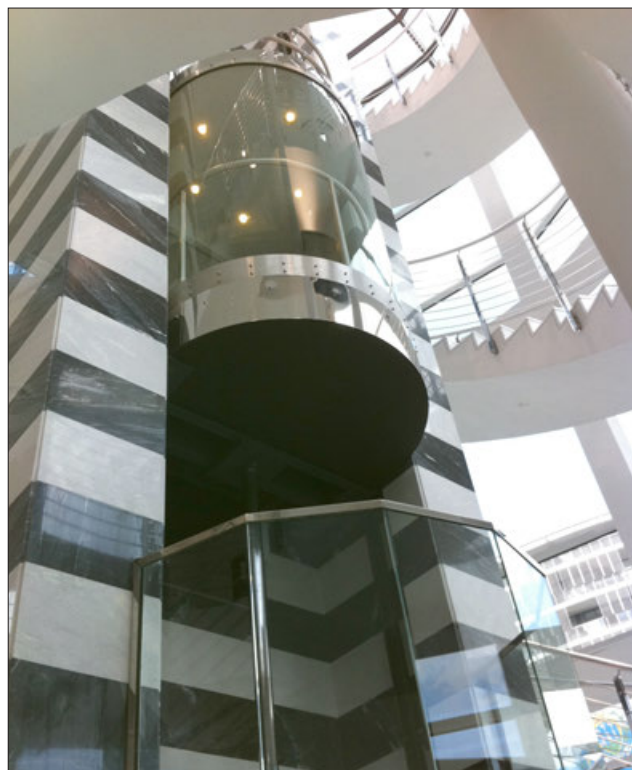
Ascensore senza vano corsa collocato all'interno di una sede aziendale. Elevator placed inside a corporate office.
